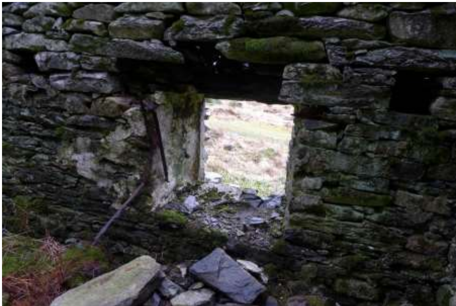
Skader på mur over vindusåpning. Ståldrageren er opprustet og ødelagt. Ståldrageren ønskes erstattet med en betongdrager.
